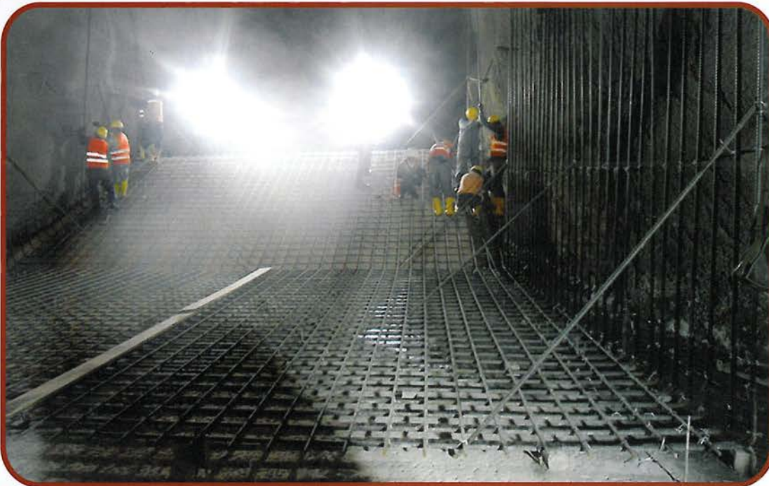
CENTRAL HIDROELÉCTRICA SOPLADORA - 487 MW -
