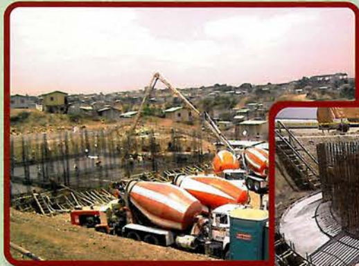
Reservorio de agua potable - Flor de Bastión -
