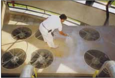
Fotografija: Quimilock SA Izdelek: VpCI®-386 VpCI®-386, uporabljen na HVAC opremi. Lokacija: Sevillija, Španija
