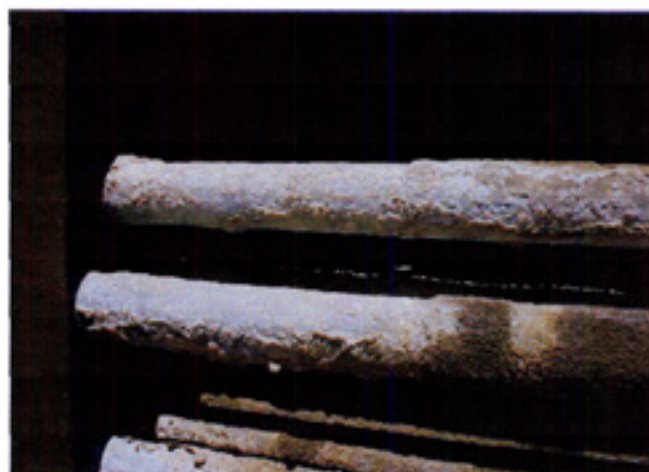
Incrustaciones calcáreas sobre los tubos del intercambiador.
