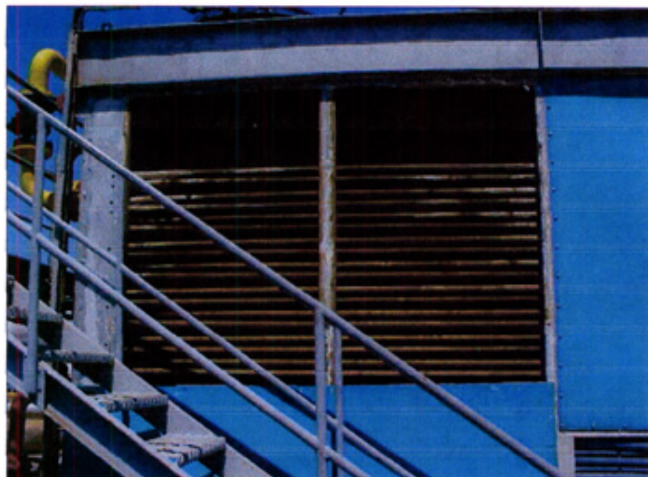
Vista exterior del condensador con las incrustaciones calcáreas.
