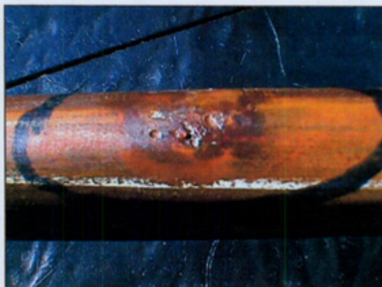
Detalle de la presencia de una picadura durante el análisis visual de un tubo de cobre perteneciente a un intercambiador.
