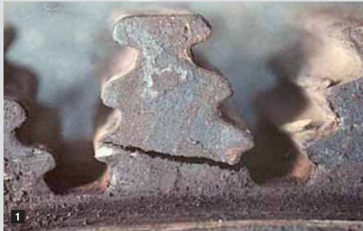
1 Typical Locations of Disc Rim Cracking. Localizzazione tipica della cricatura del cerchione.
