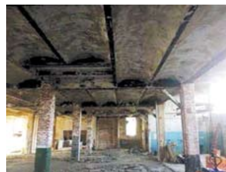
Slika 14. Izgradnja JC Century Bulding, izgled stropa prije početka radova
