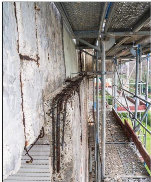
Konstrukcija od armiranog betona oštećena zbog utjecaja korozije
